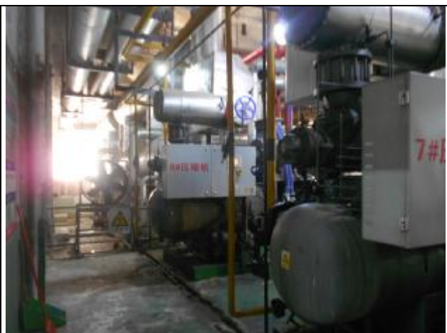
机房内空压机
