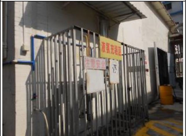
项目液氮充装区
