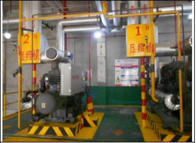
机房内空压机
