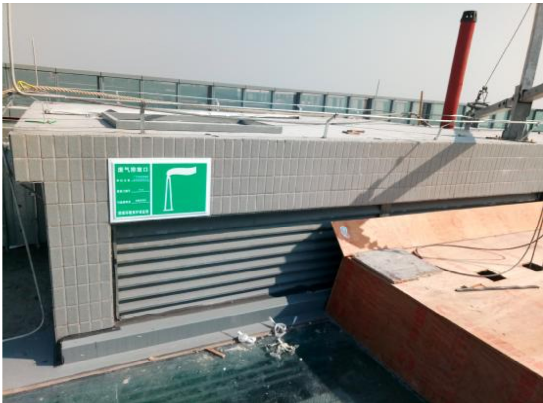
气-01 备用发电机尾气排放口
