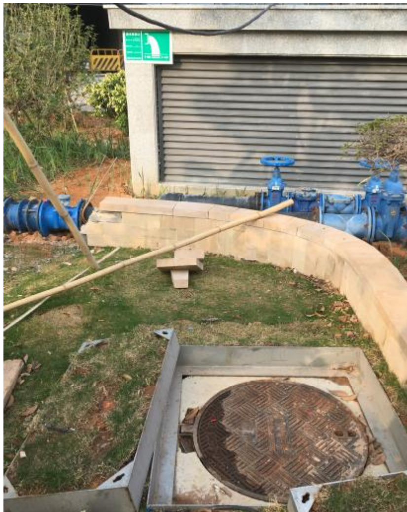
水-01 生活污水排放口（接入市政管网）
