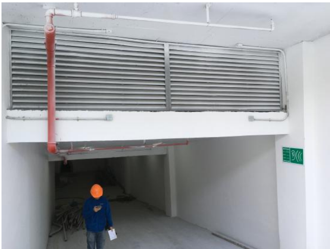
声-01 发电机房抽排风口
