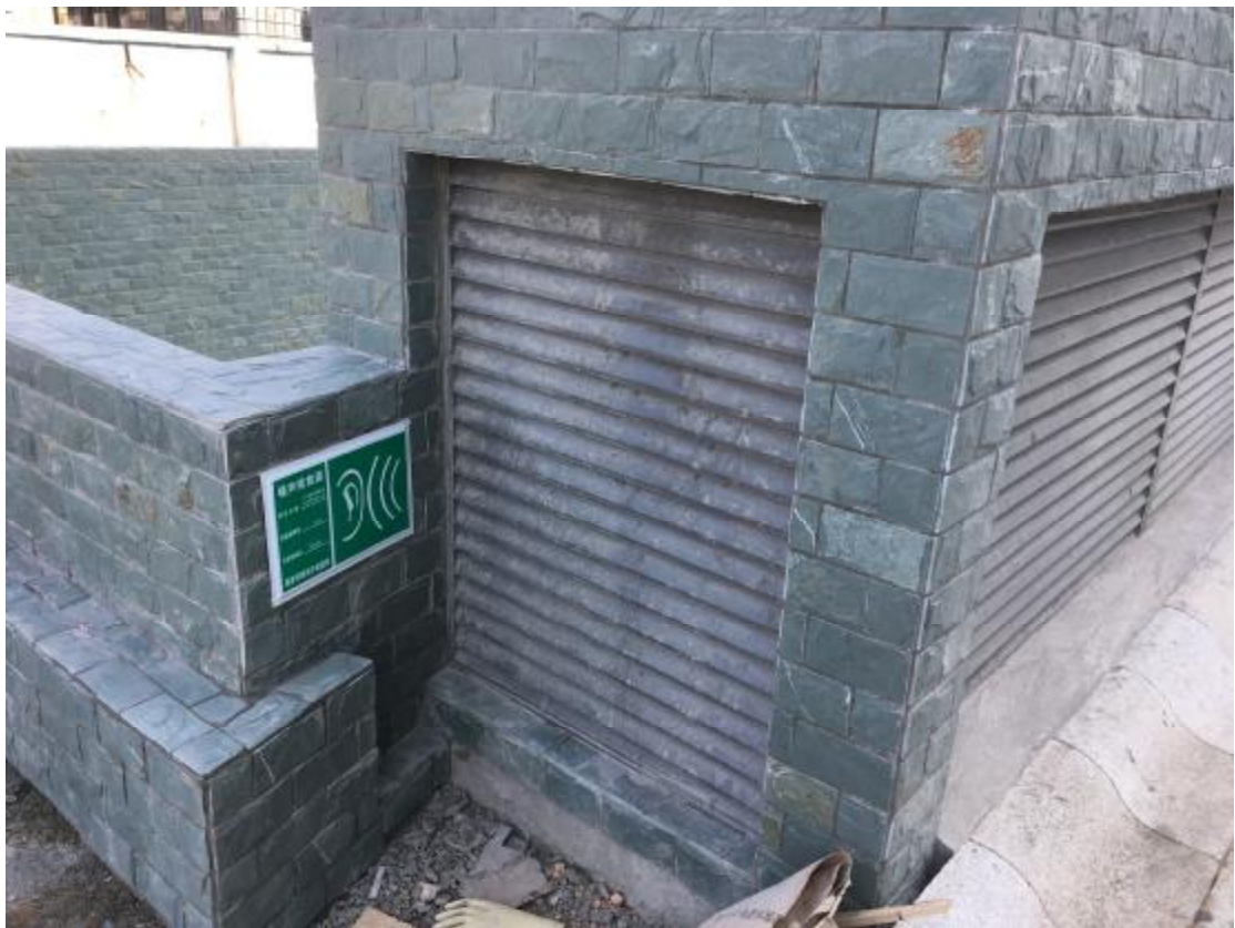
声-03 地下室风机抽排风口
