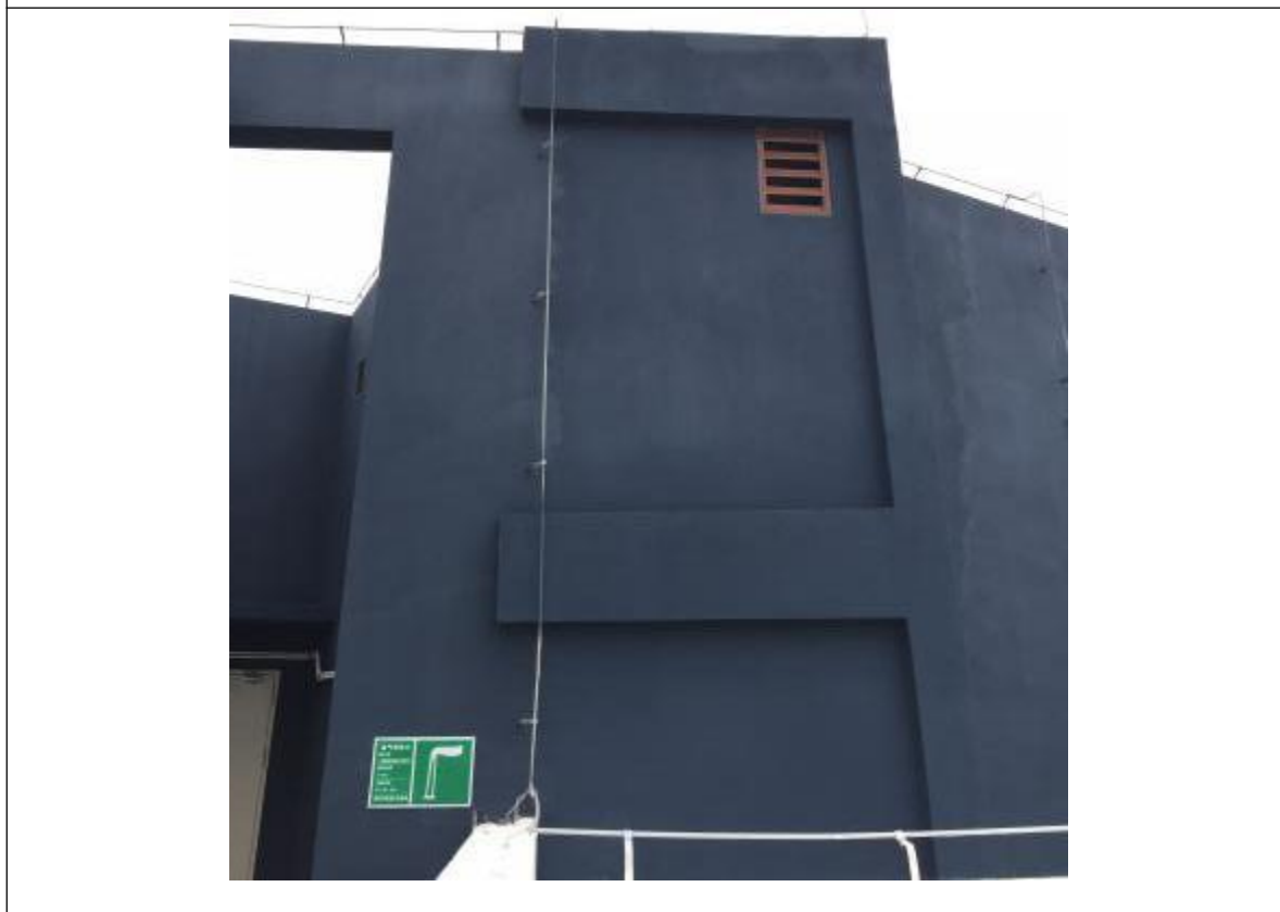
发电机尾气排放口
