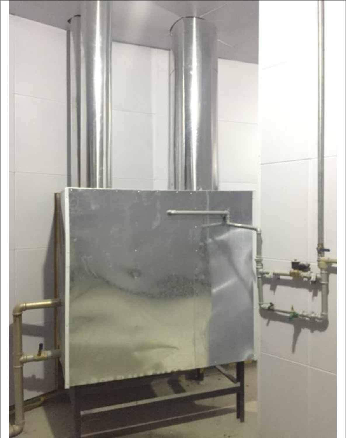
发电机水喷淋设施
