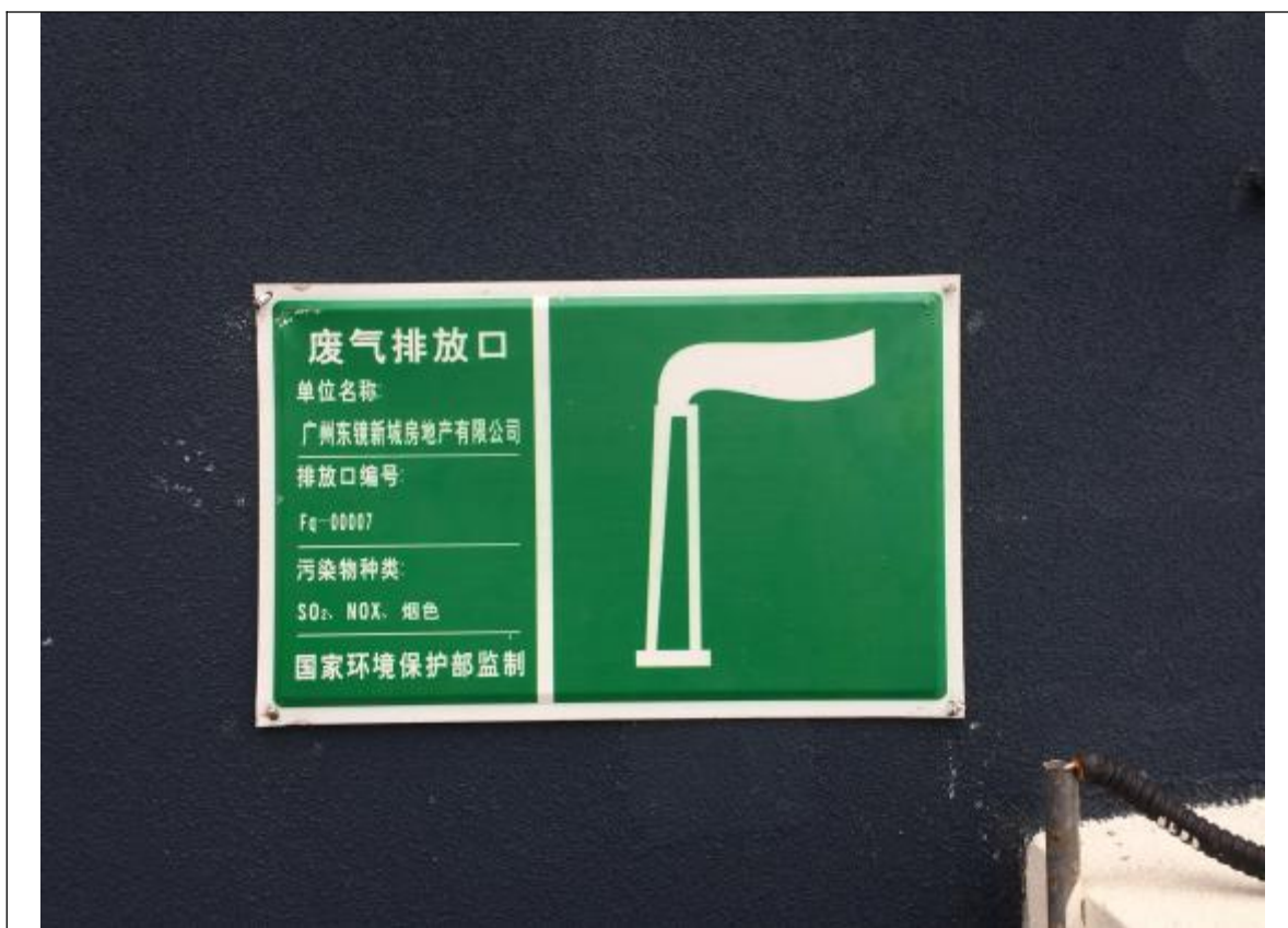
发电机尾气排放口
