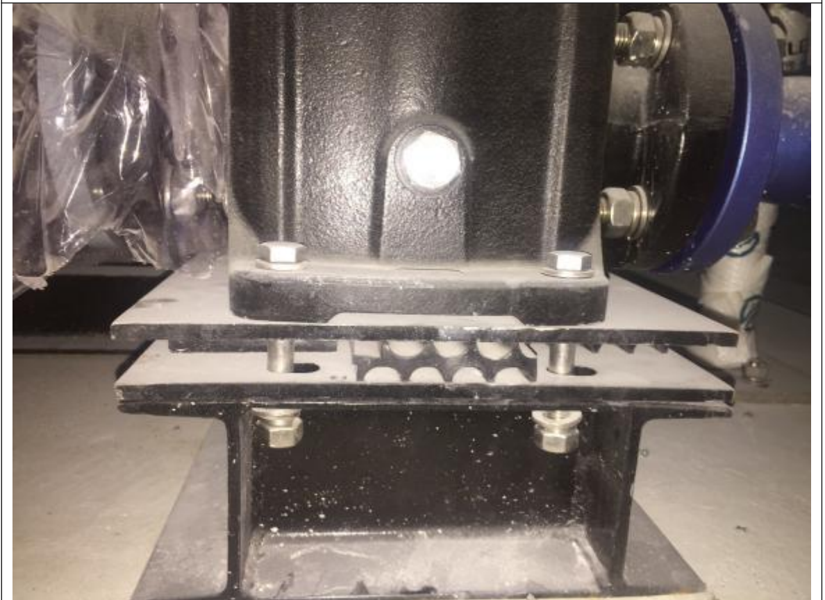
水泵减振设施
