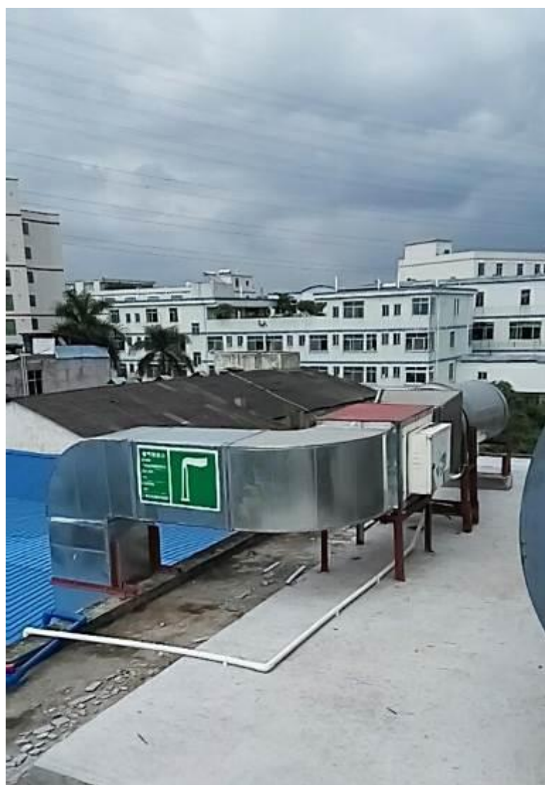
气-02 油烟废气排放口
