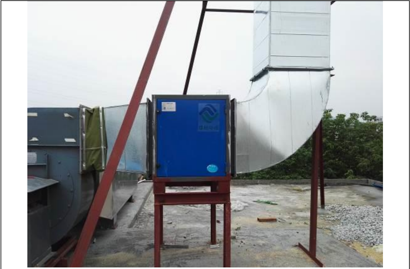
有机废气处理：UV光解+活性炭吸附设备
