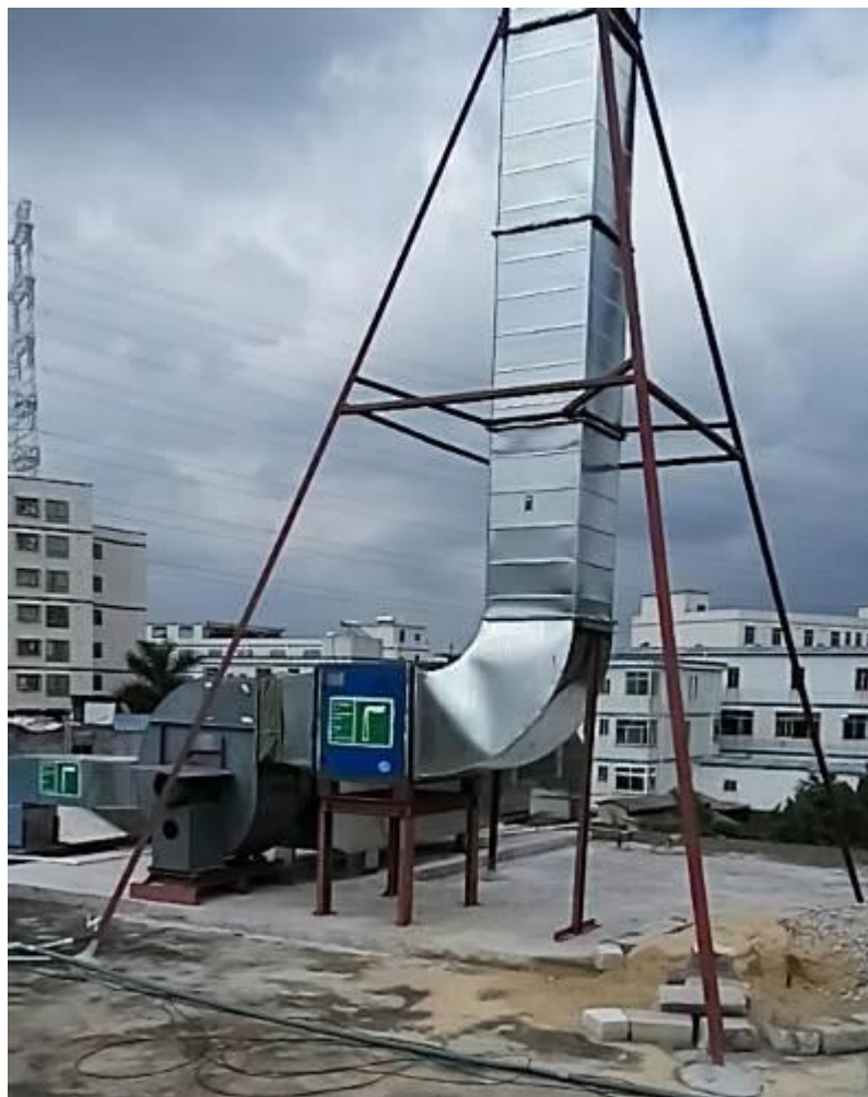
气-01 有机废气排放口
