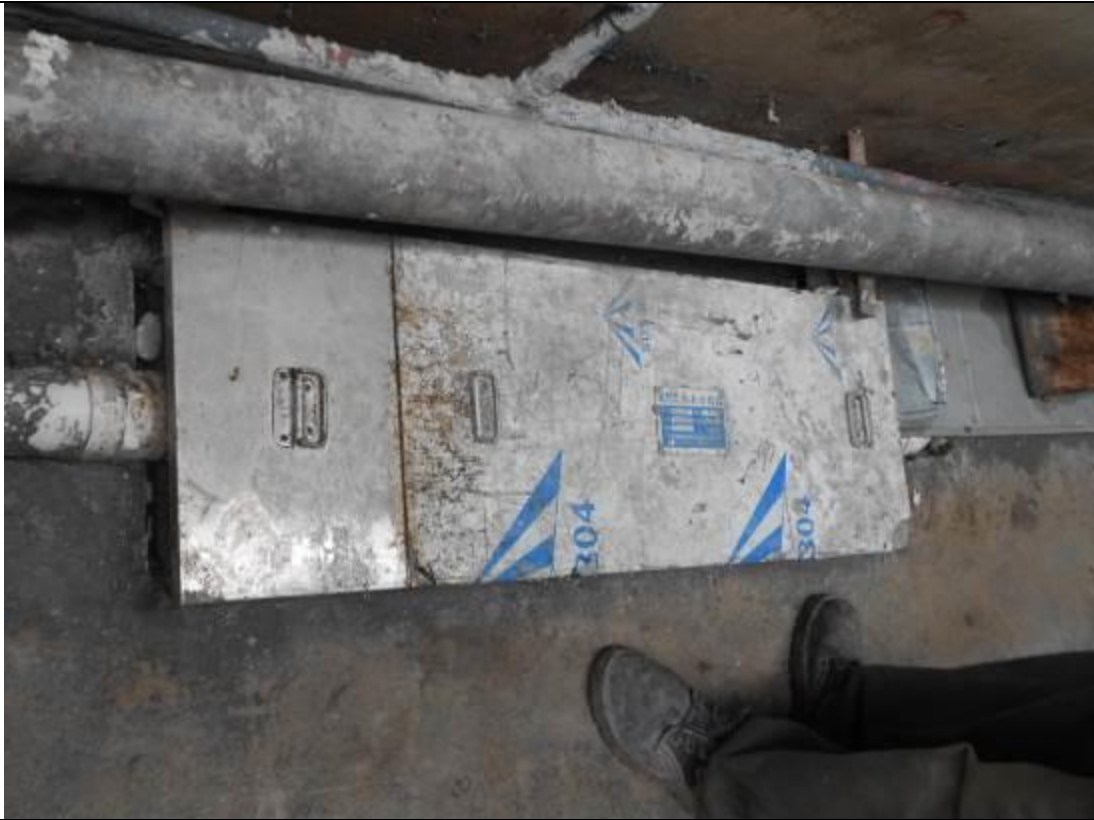
食堂含油污水处理：油水分离器
