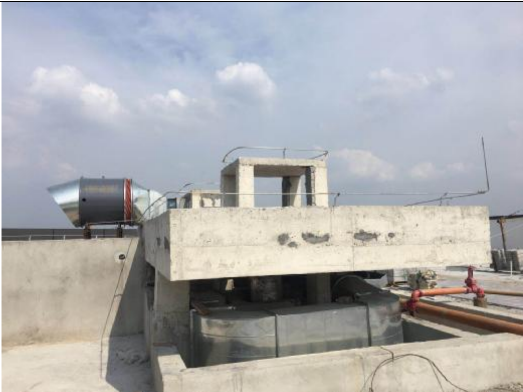
自编1#商业办公楼天面备用发电机燃油尾气排放口
