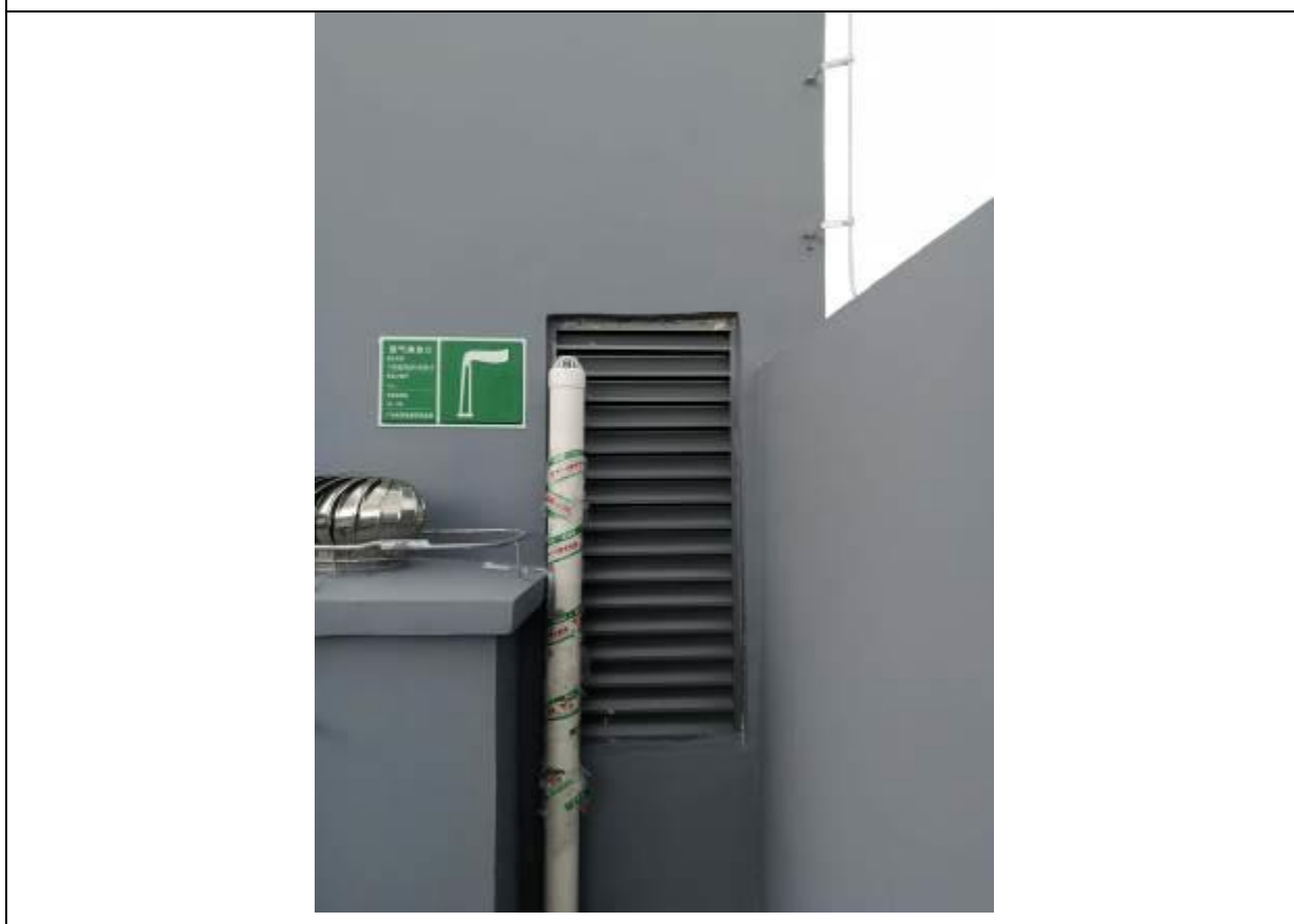
发电机尾气排放口：气-02（远照）
