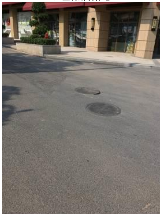
项目污水与市政污水管网接驳位置
