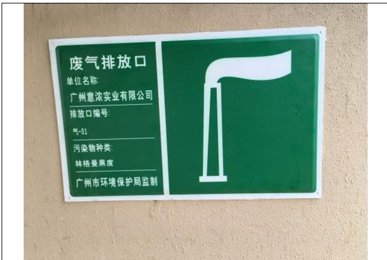
发电机尾气排放口：气-01（近照）
