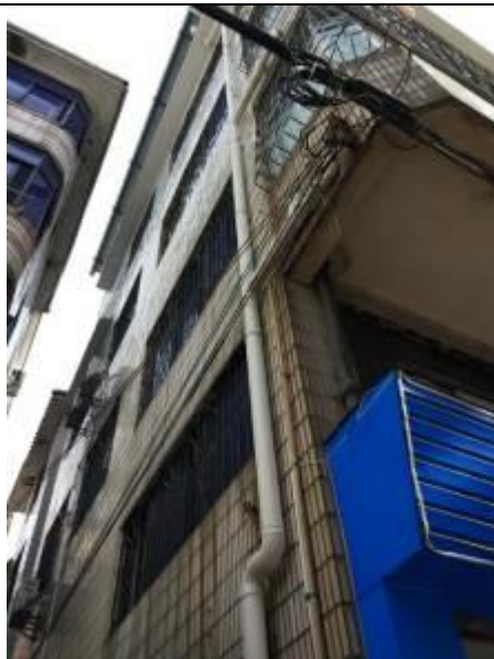
村内排水现状-建筑立管雨污混接
