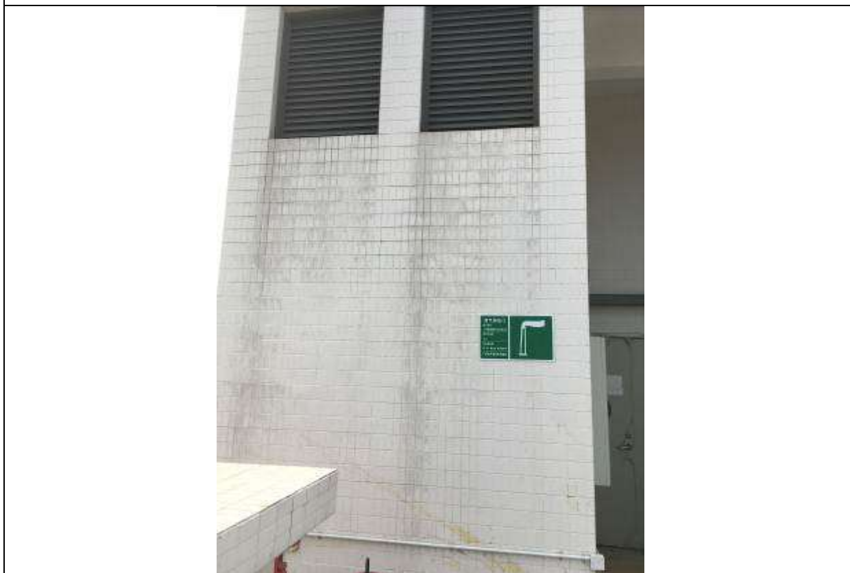
发电机废气排放口：气-02（远照）
