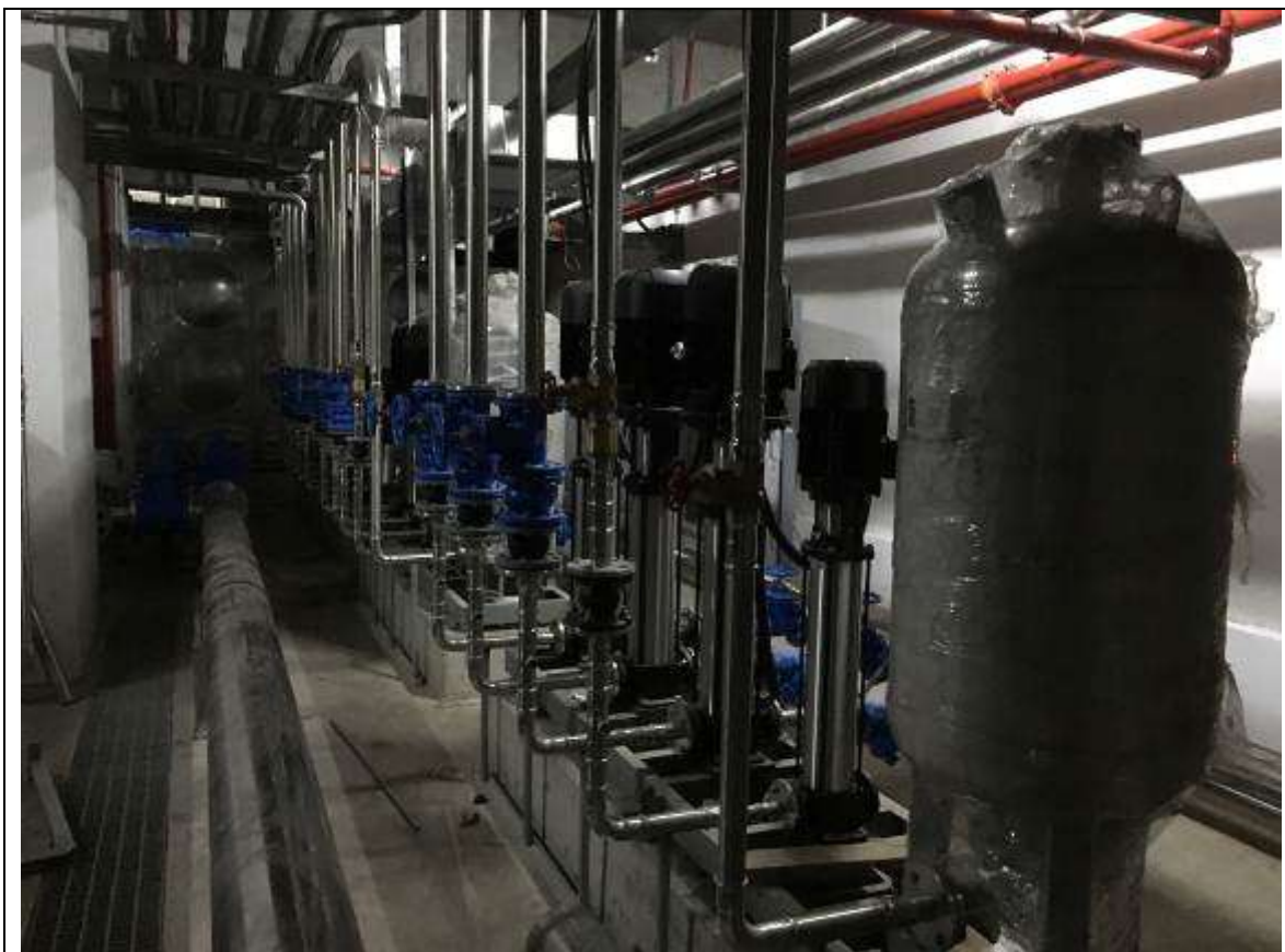
制冷机组减振
