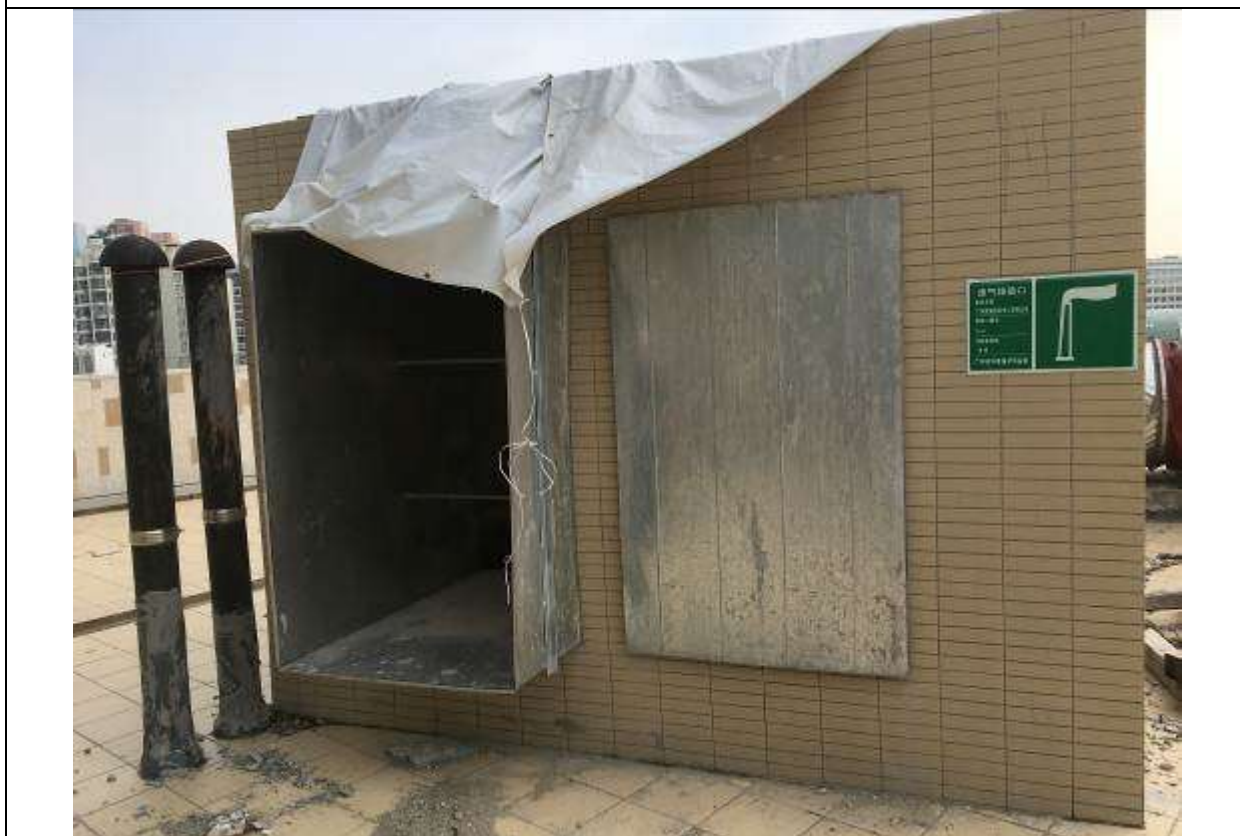
油烟废气排放口：气-03（远照）
