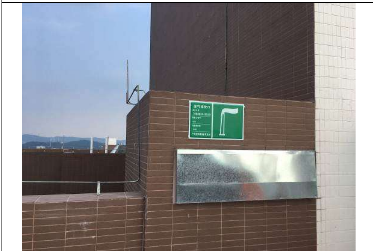
油烟废气排放口：气-04（远照）
