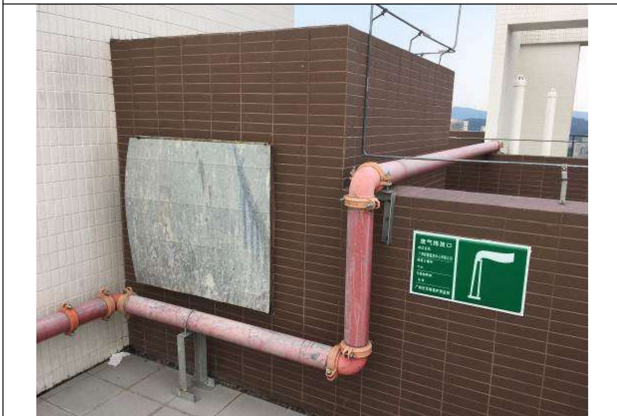
油烟废气排放口：气-05（远照）
