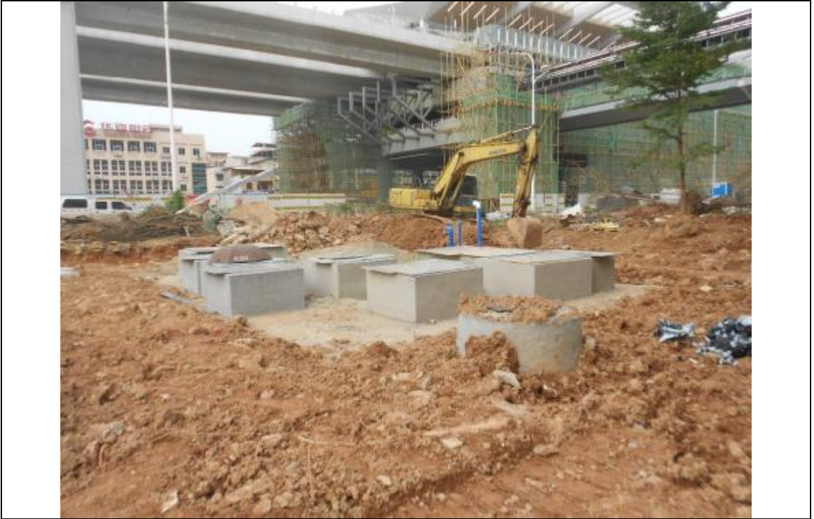
自建污水处理设施
