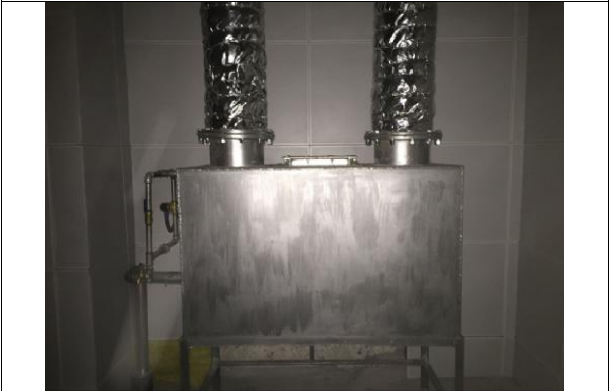
发电机房水喷淋装置
