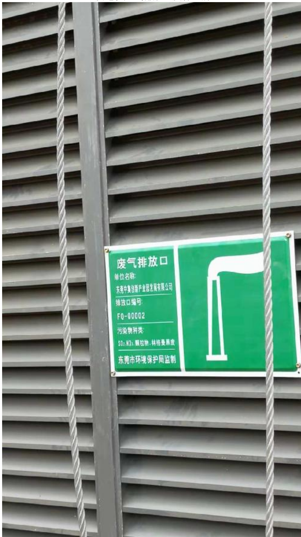
发电机尾气排放口及标志牌
