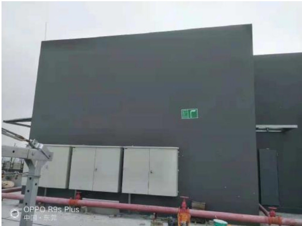
发电机尾气排放口及标志牌（远）
