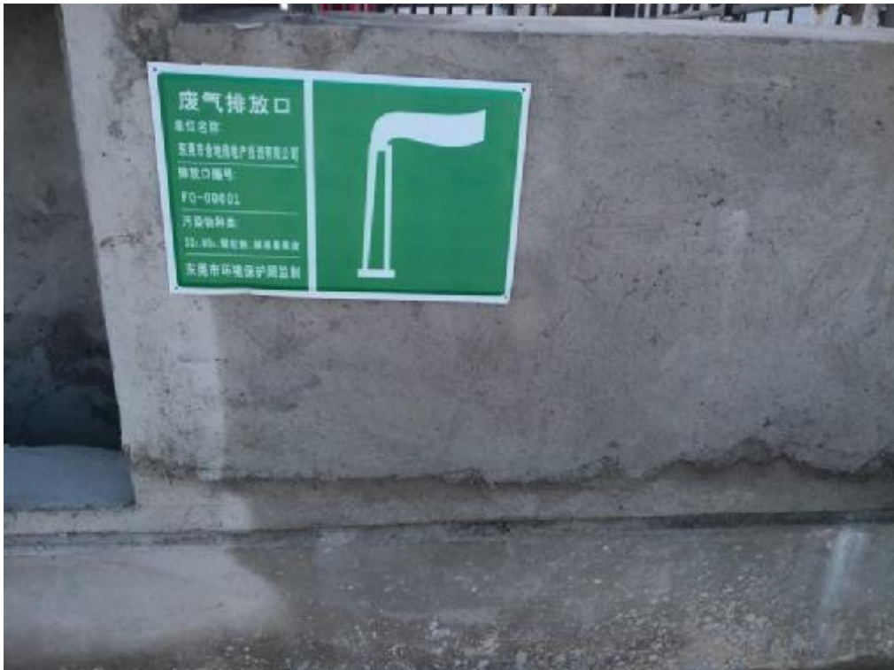
发电机尾气排放口及标志牌（近）
