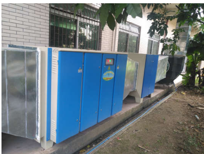
项目废气处理设施
