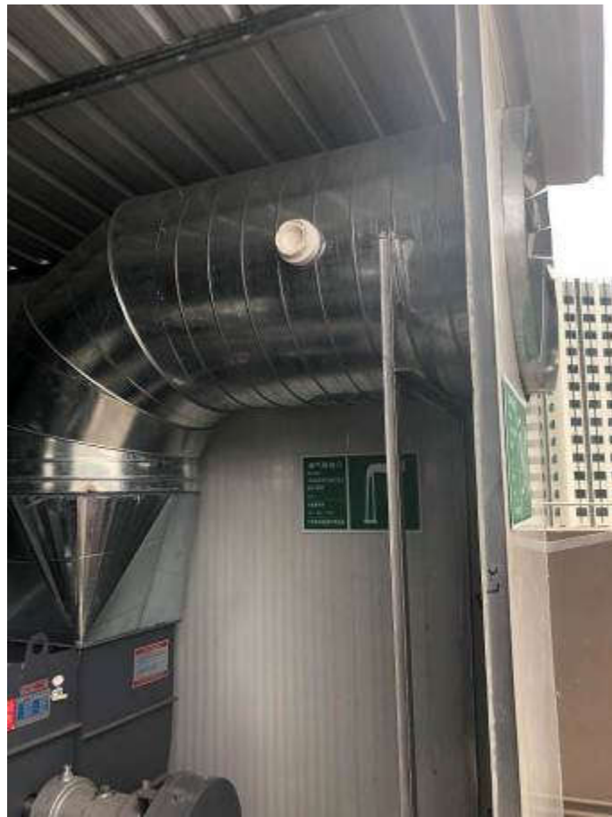
气-03 废气排放口
