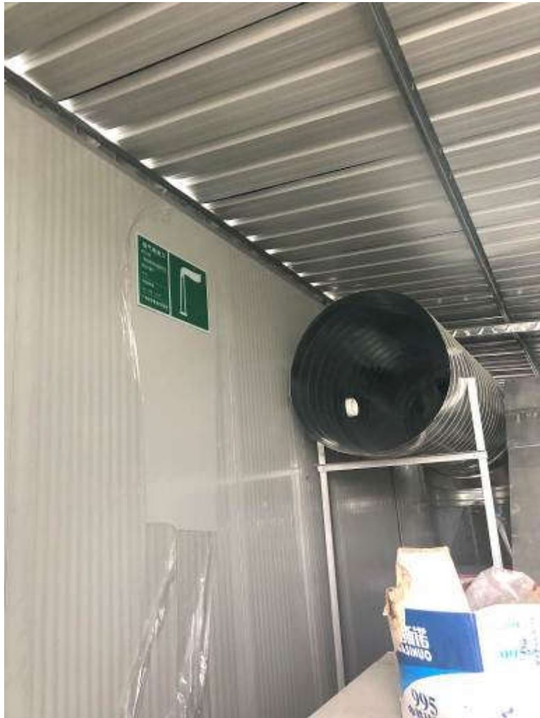
气-02 废气排放口
