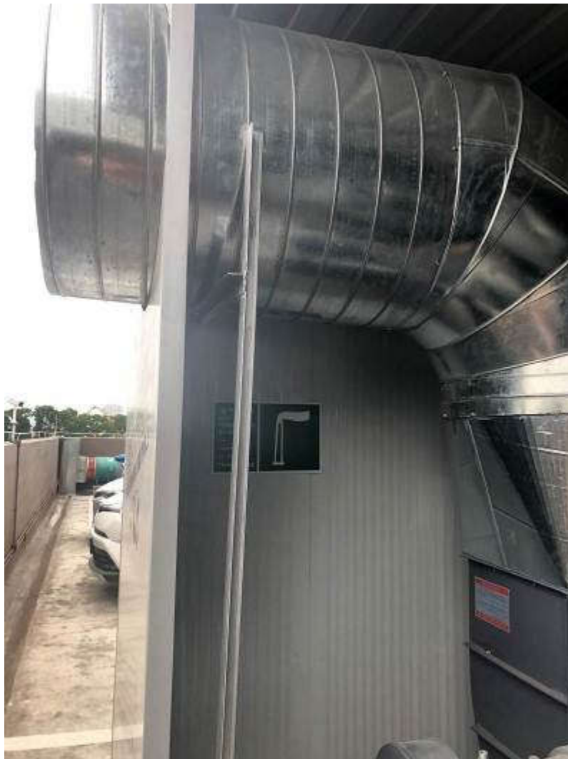
气-04 废气排放口
