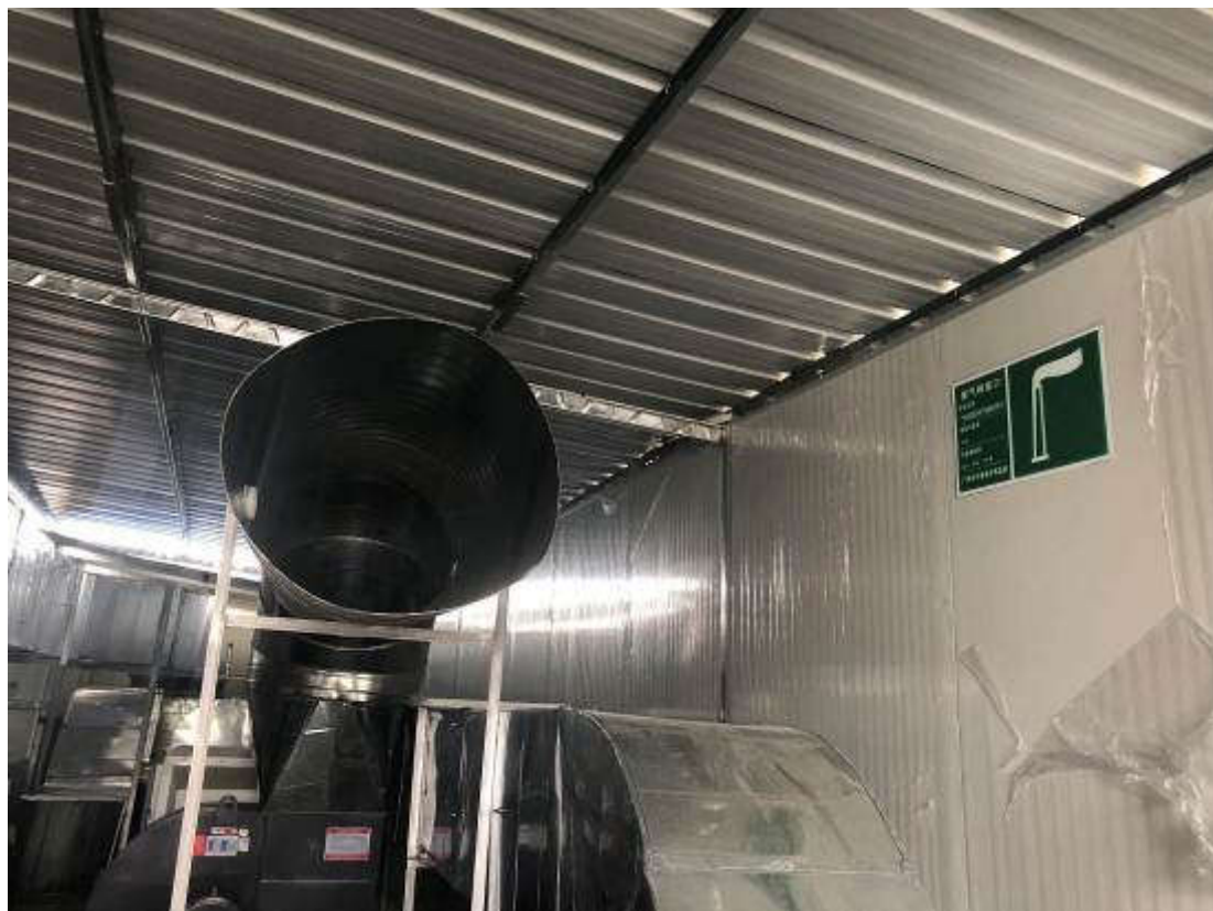
气-01 废气排放口
