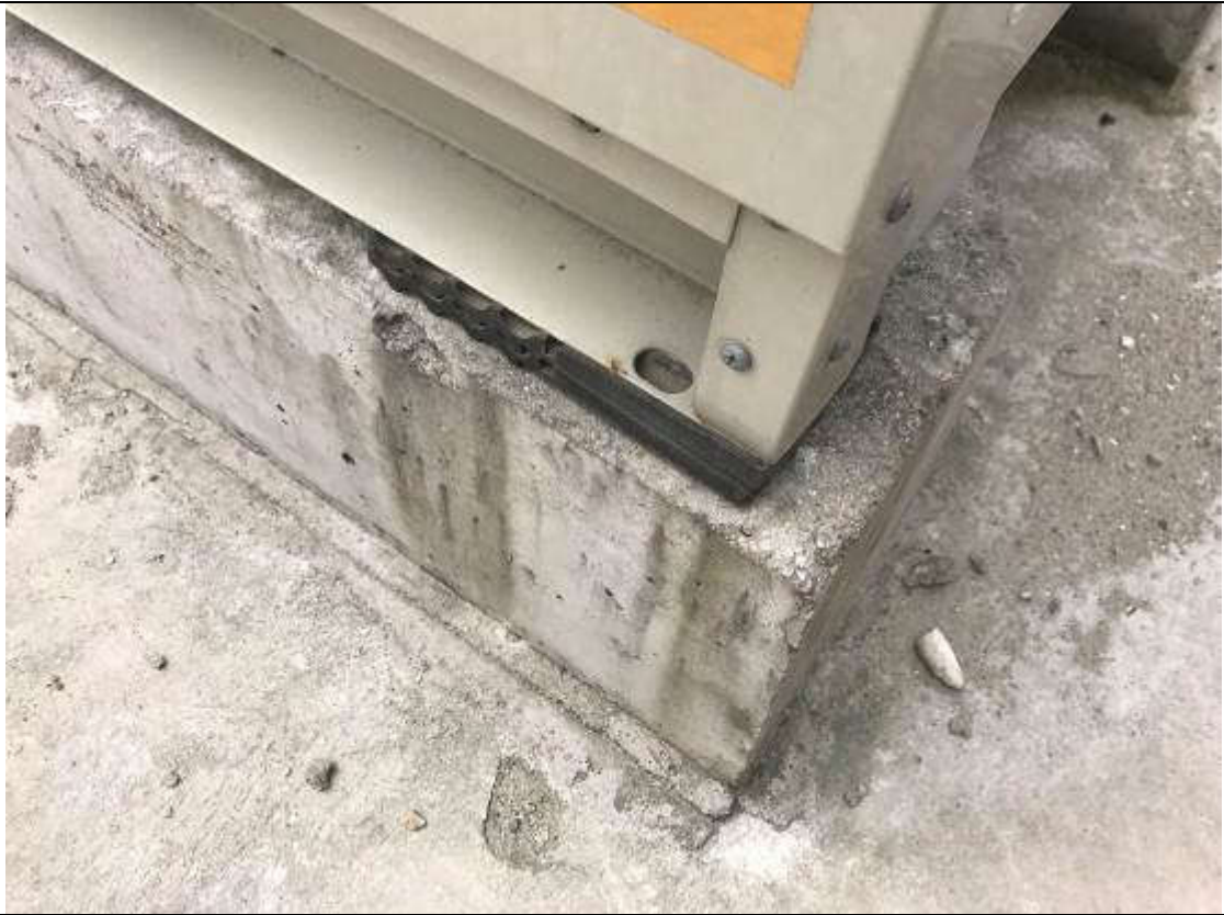
多联机空调机组减振
