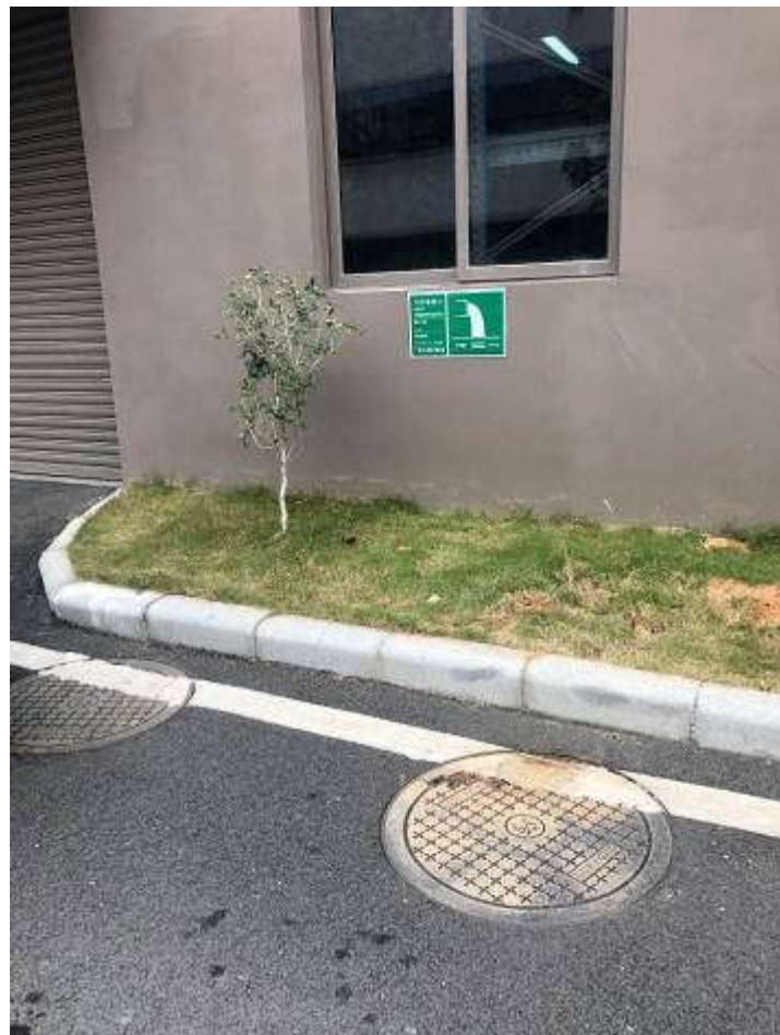
水-01 废水排放口
