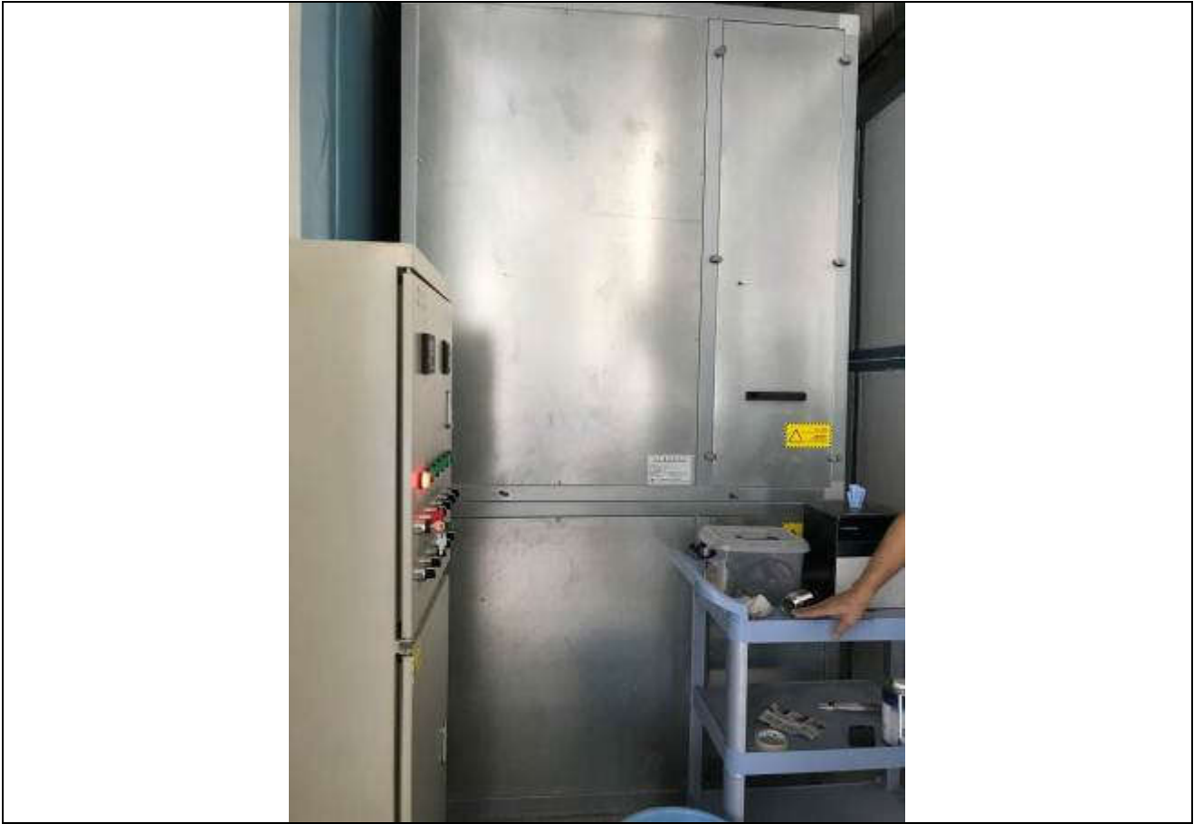
废气处理：活性炭吸附箱
