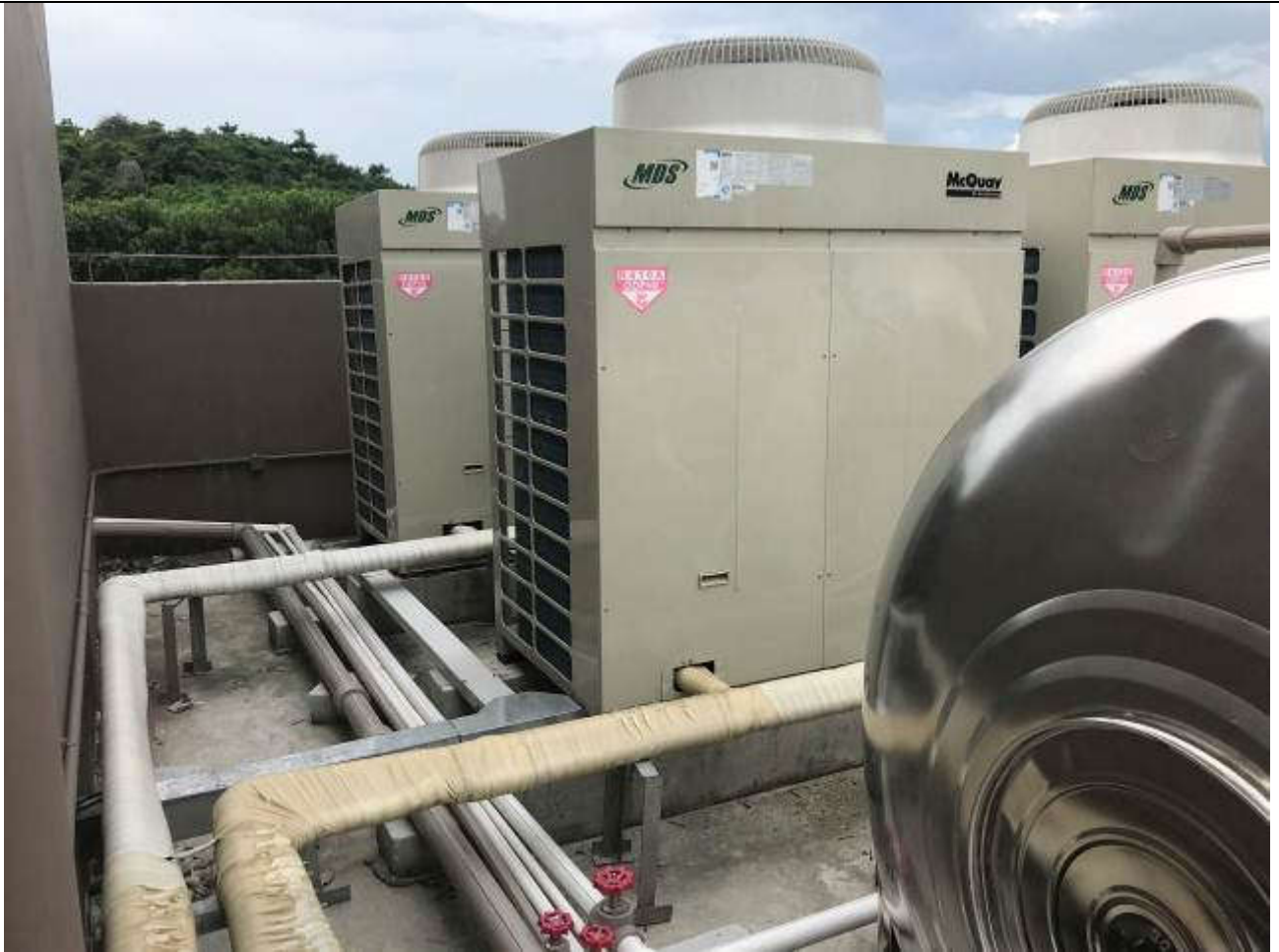
多联机空调机组减振
