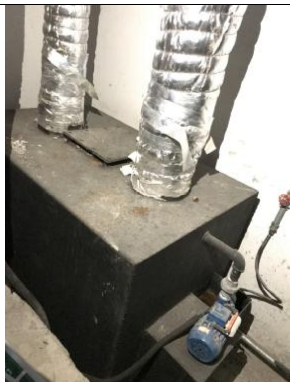
发电机房水喷淋装置
