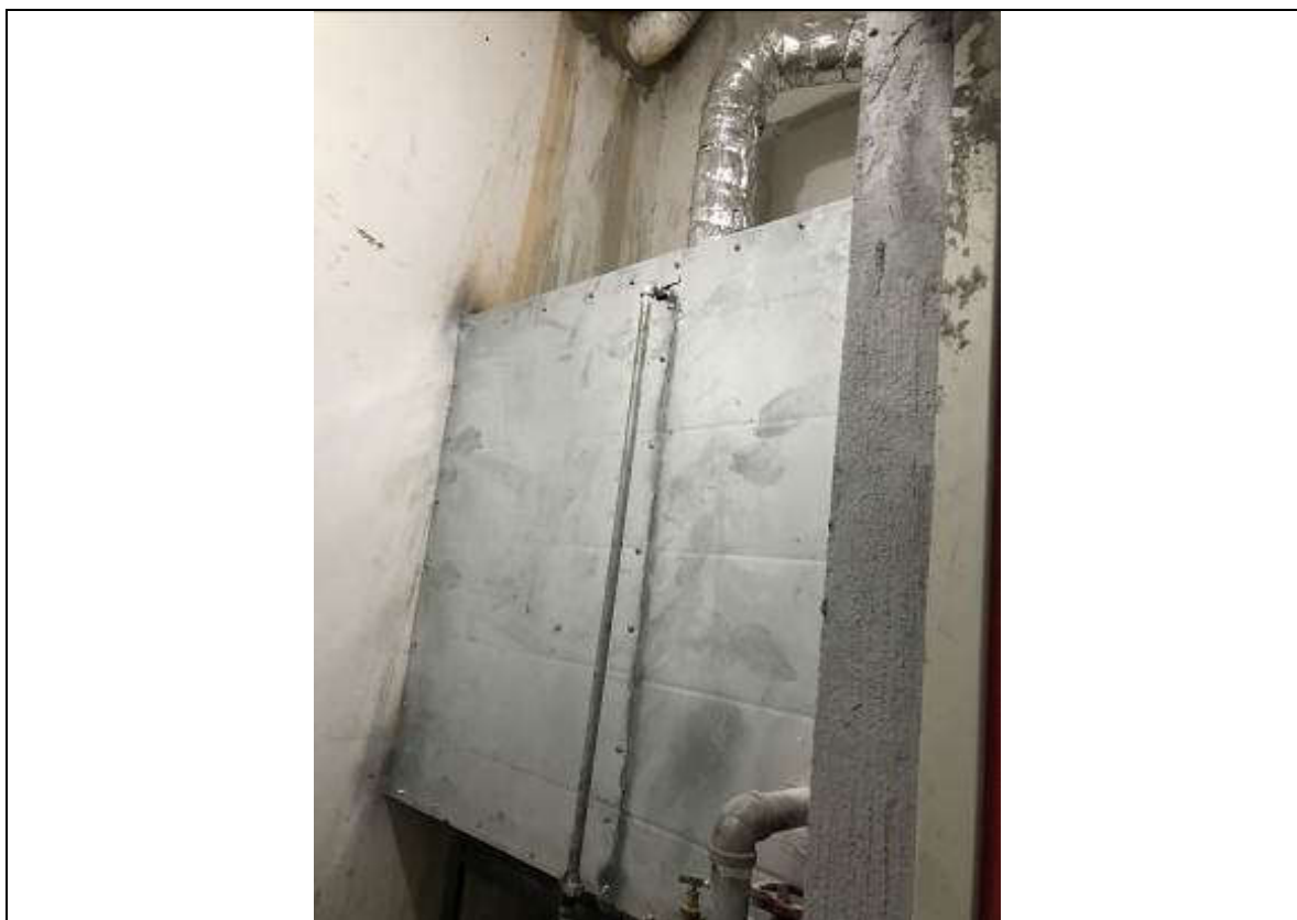
发电机水喷淋设施
