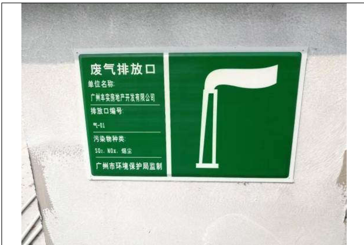
发电机尾气排放口：气-01（近照）
