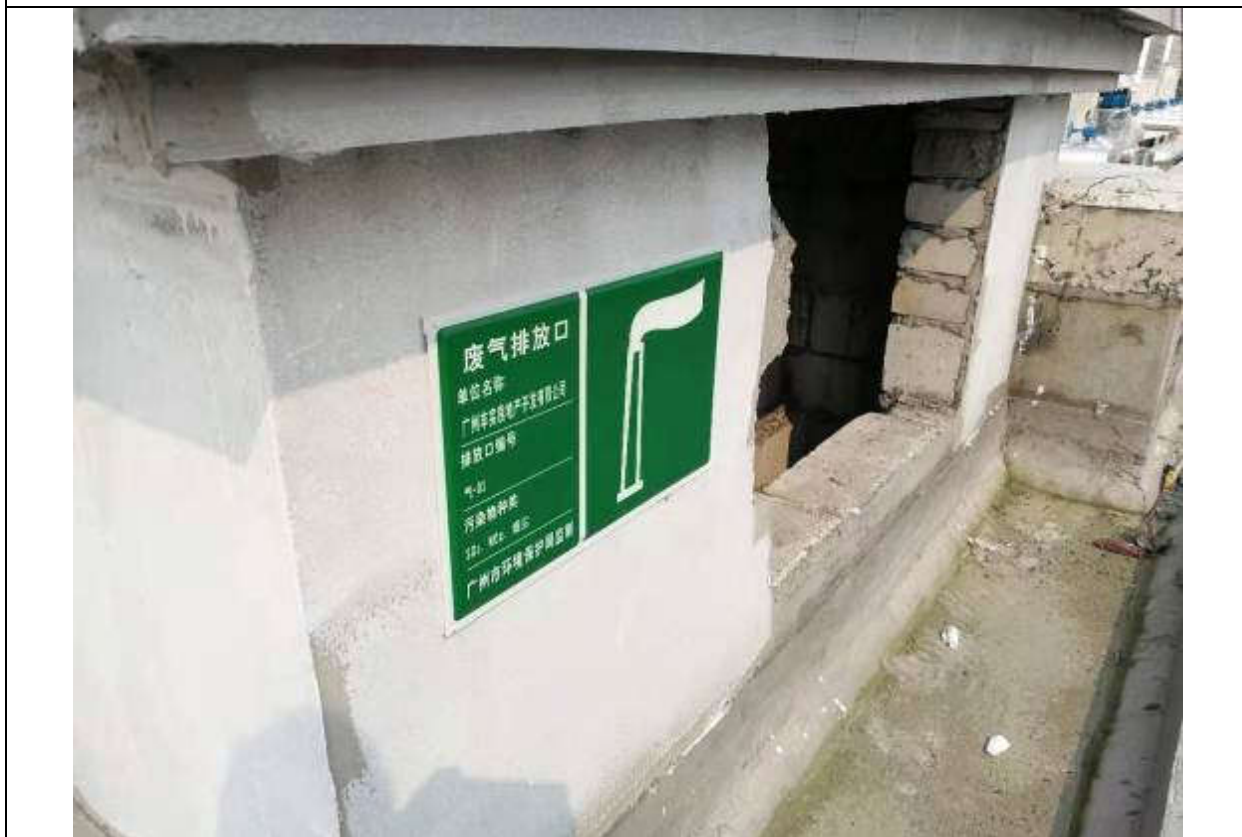
发电机尾气排放口：气-01（远照）
