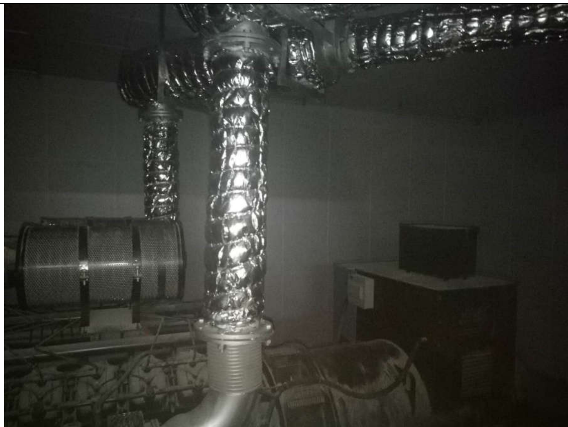
发电机房吸声墙及排烟管
