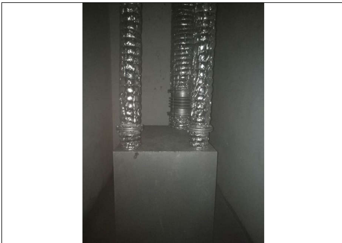
发电机水喷淋设施
