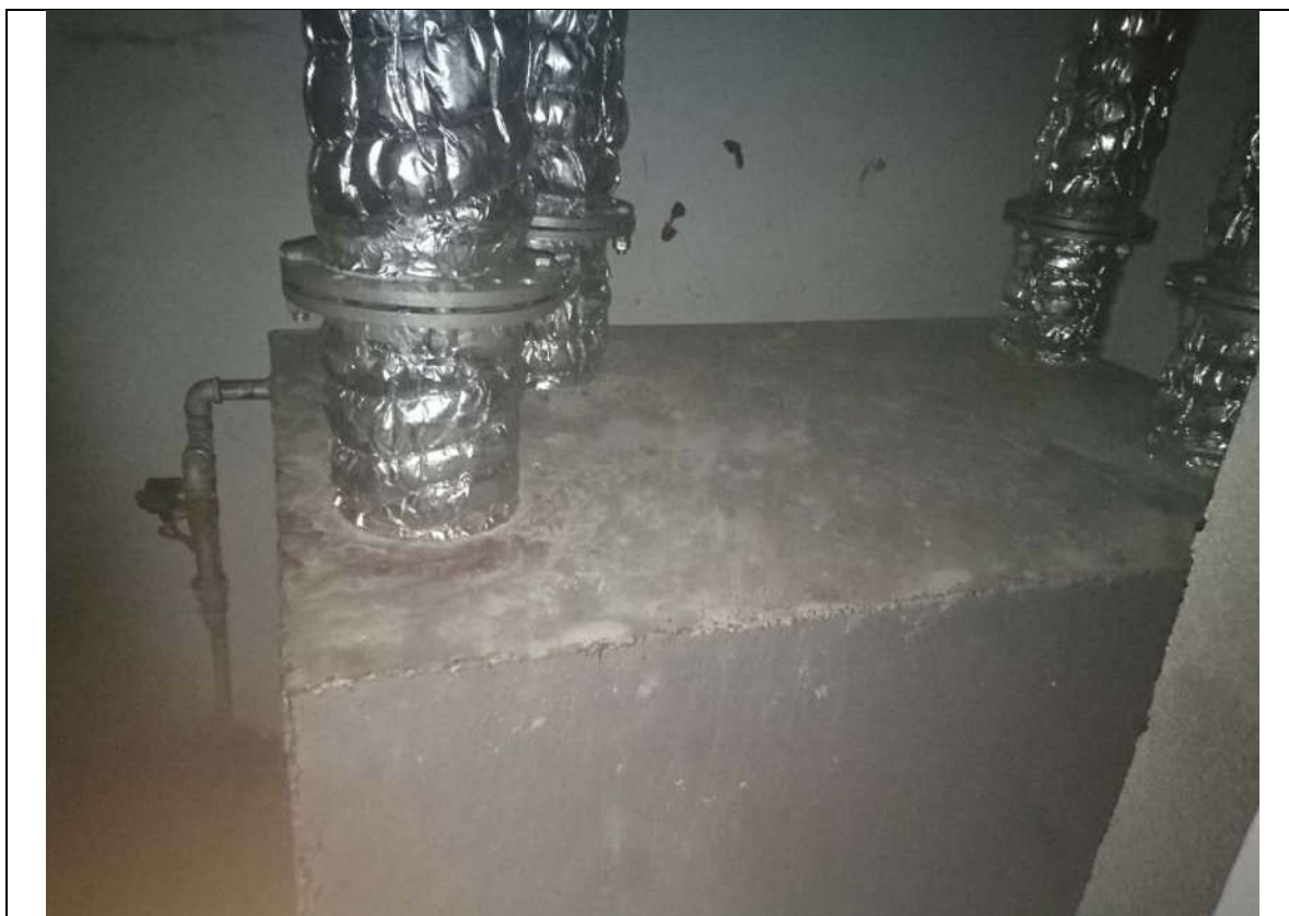
发电机水喷淋设施
