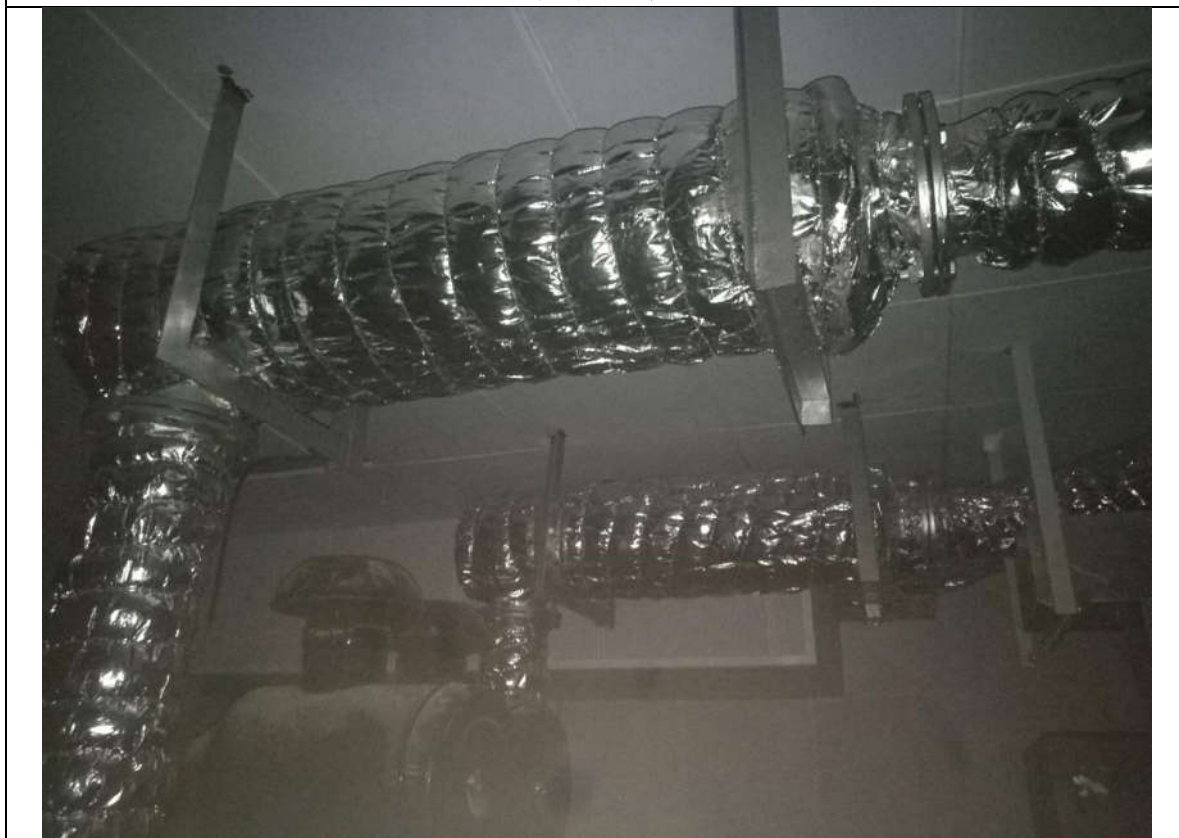
发电机房吸声墙及排烟管
