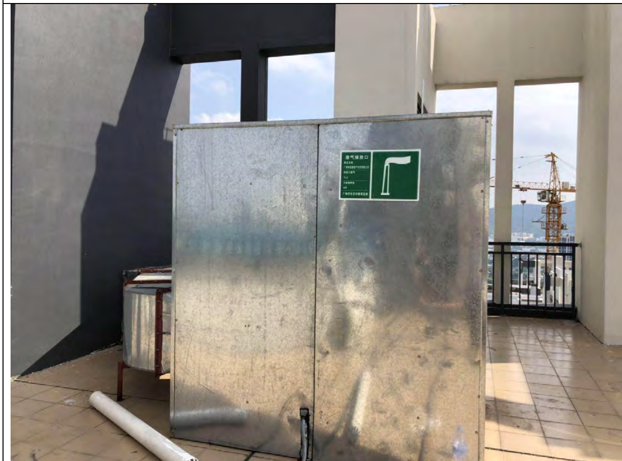
废气排放口：气-03（远照）
