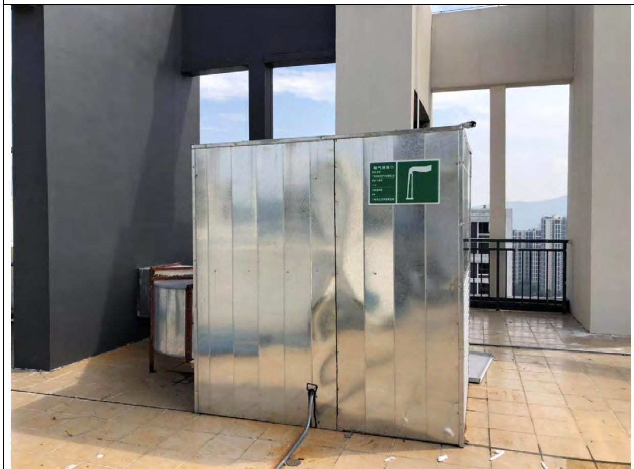
废气排放口：气-05（远照）
