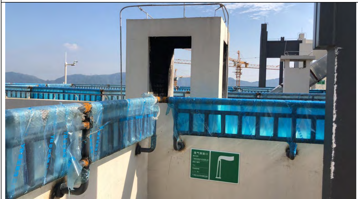
废气排放口：气-01（远照）
