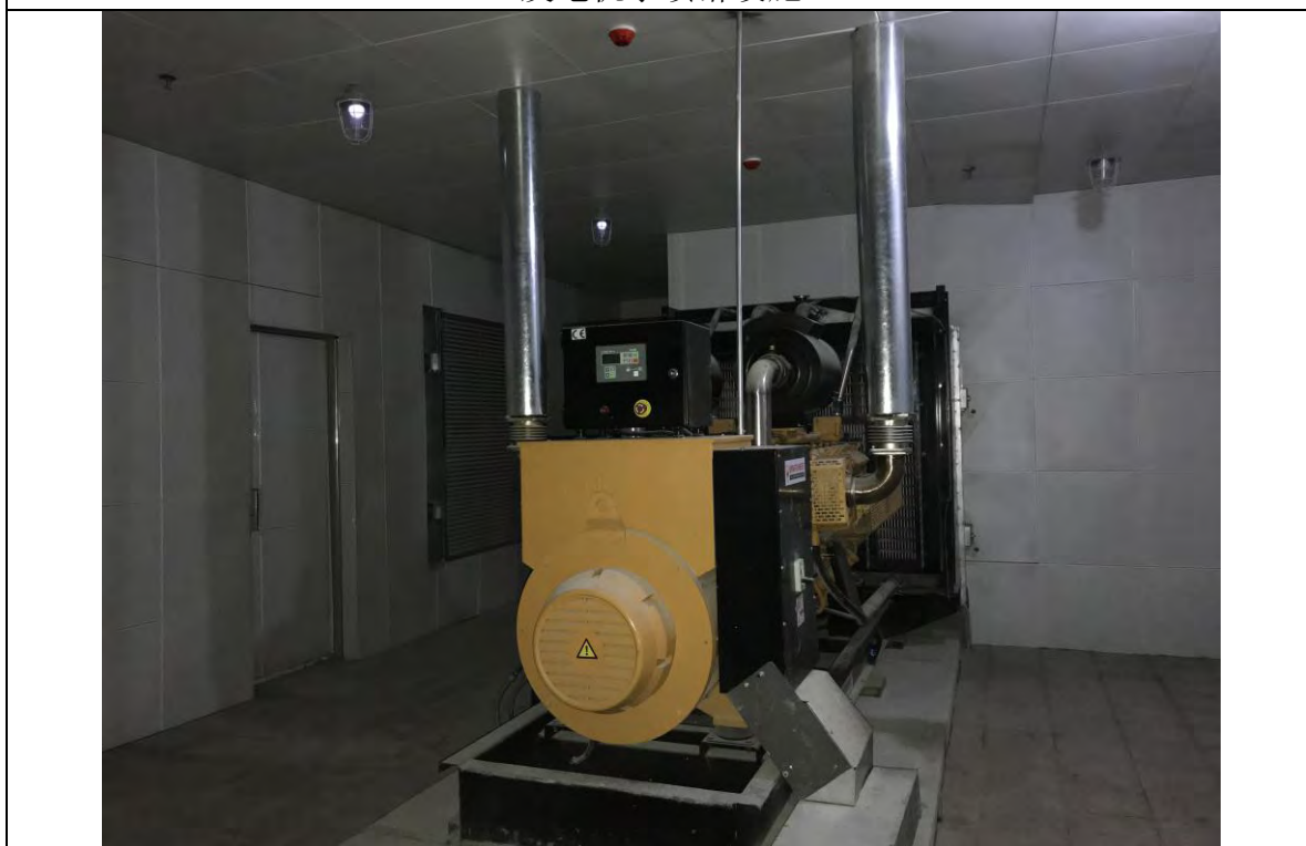
发电机房吸声墙及排烟管
