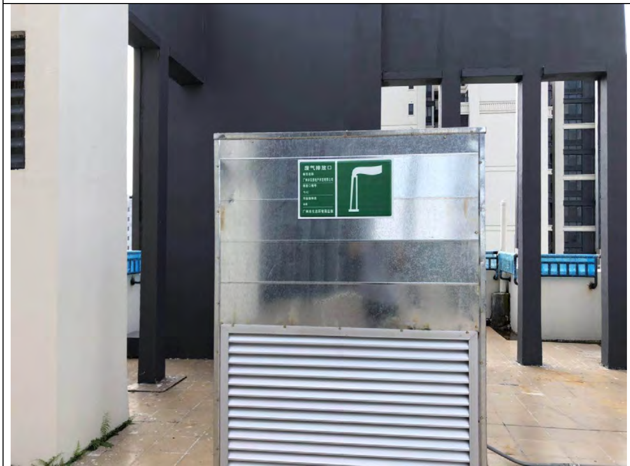
废气排放口：气-02（远照）
