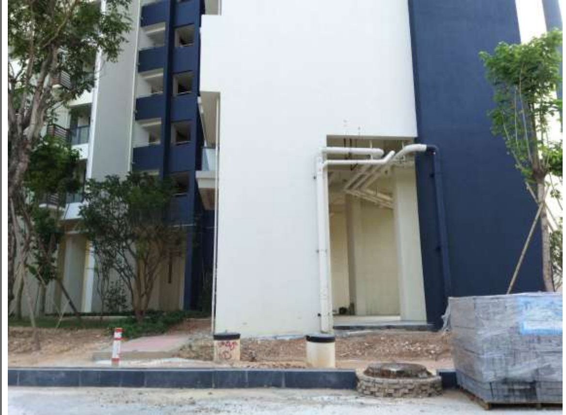
自由人花园污水总排放口
