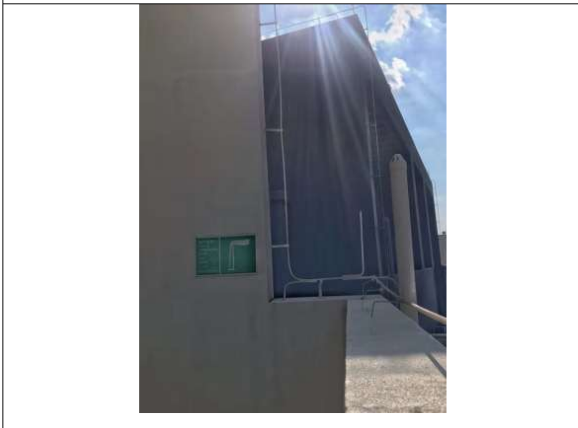
发电机尾气排放口
