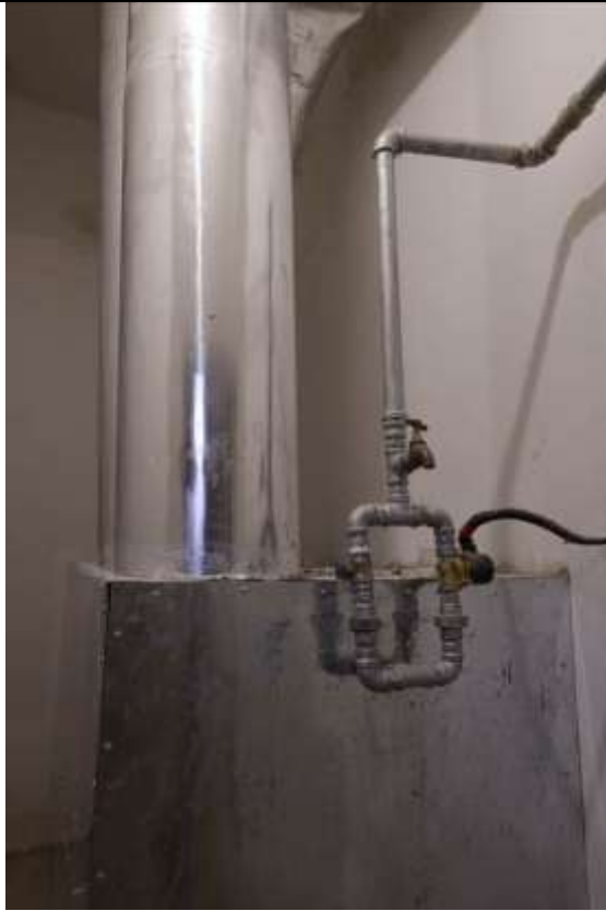
发电机水喷淋设施
