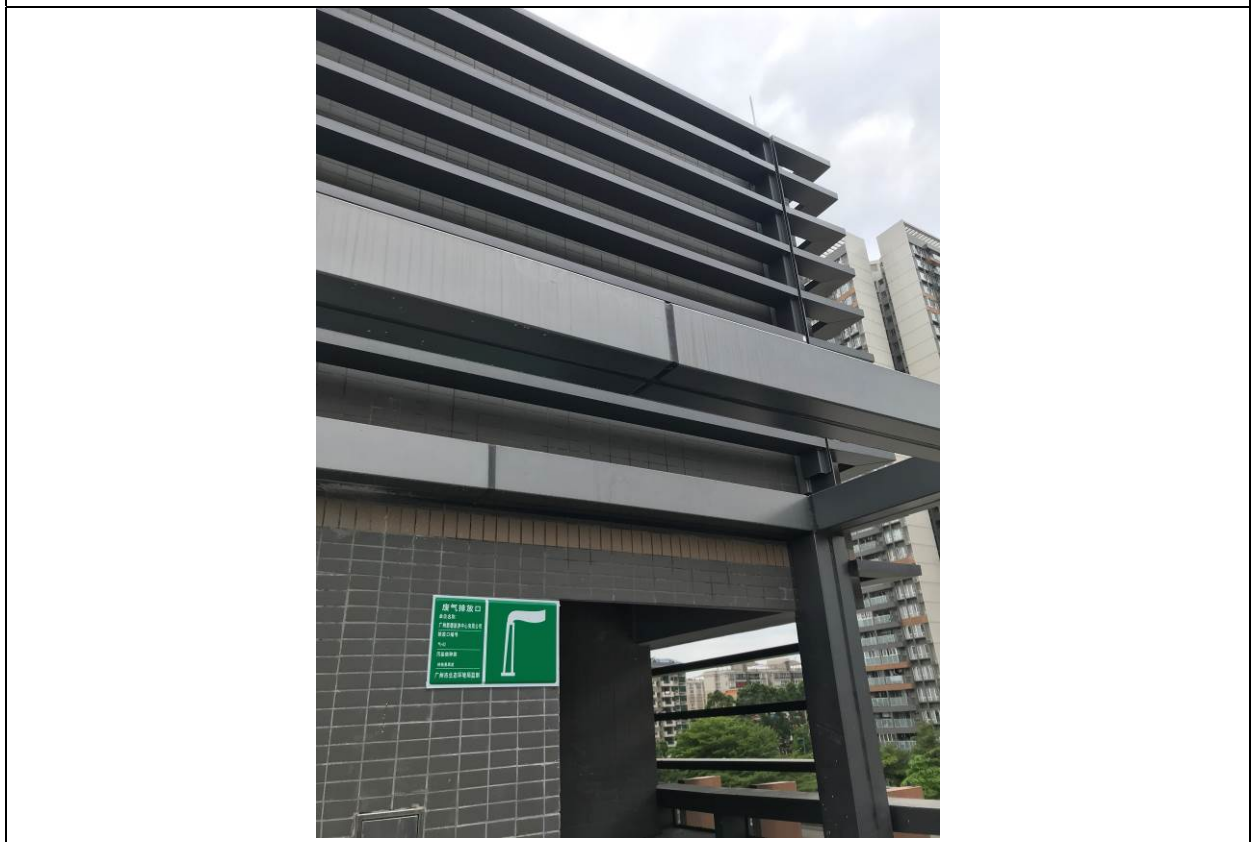
发电机尾气排放口：气-02（远照）
