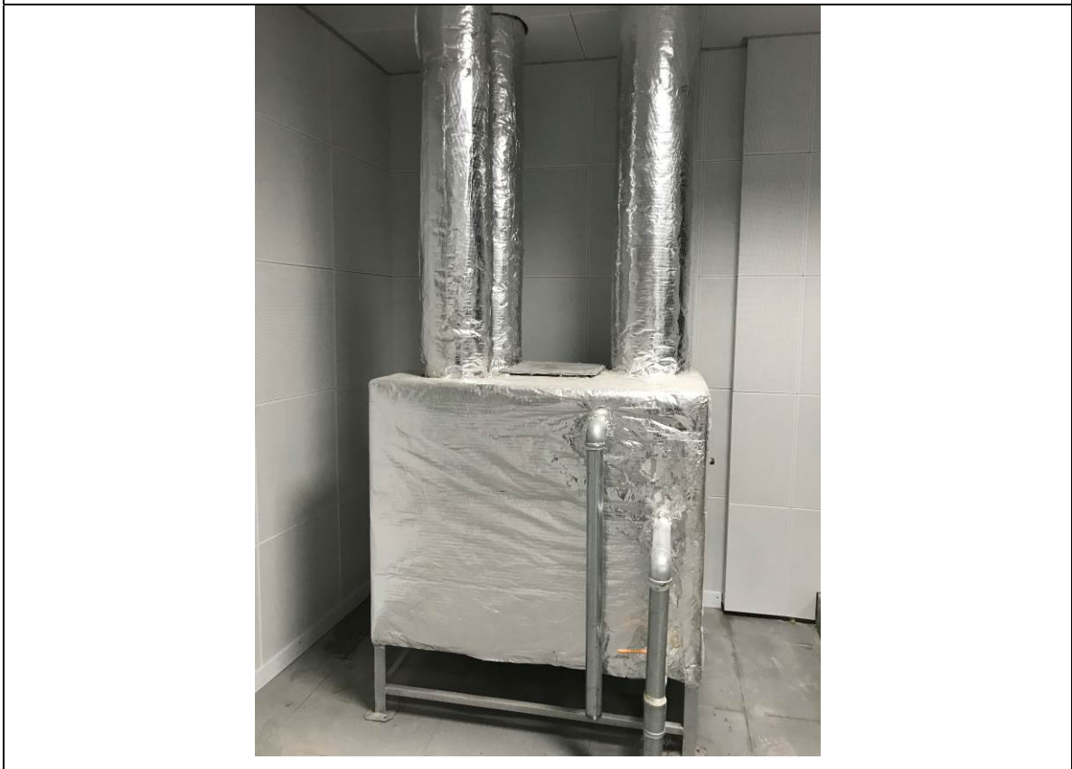
发电机水喷淋设施
