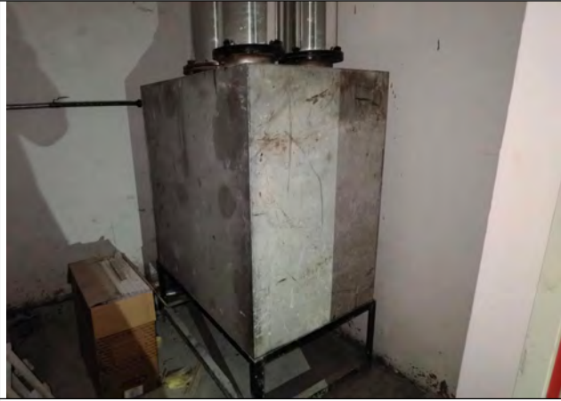
发电机房水喷淋装置
