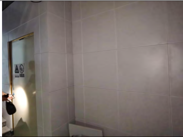
发电机房隔音降噪
