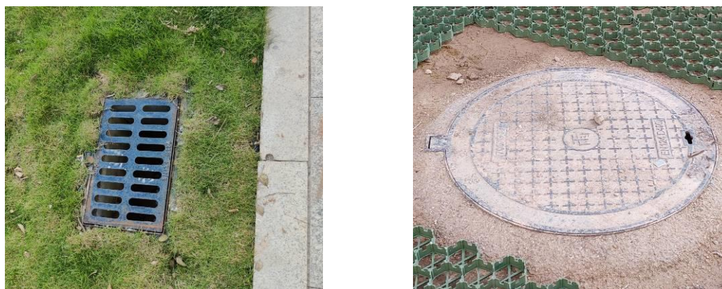
图4.1-1 水土保持工程措施现状
