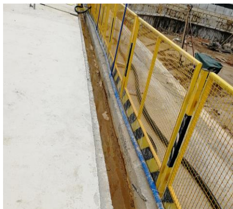
地块DEF基坑顶部截水沟
