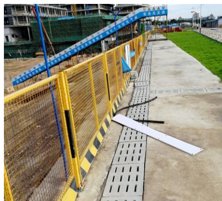
地块C基坑顶部截水沟
