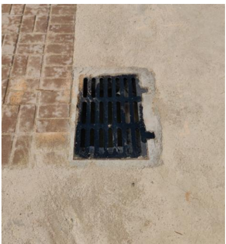
幼儿园雨水排水口
