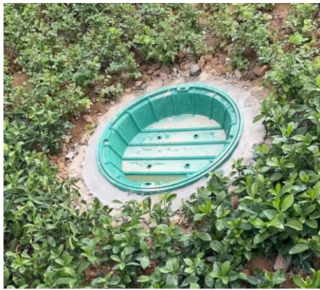
自编1#、3#楼雨水排水井
