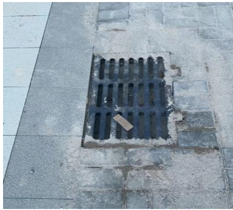
自编1#、3#楼雨水排水口
