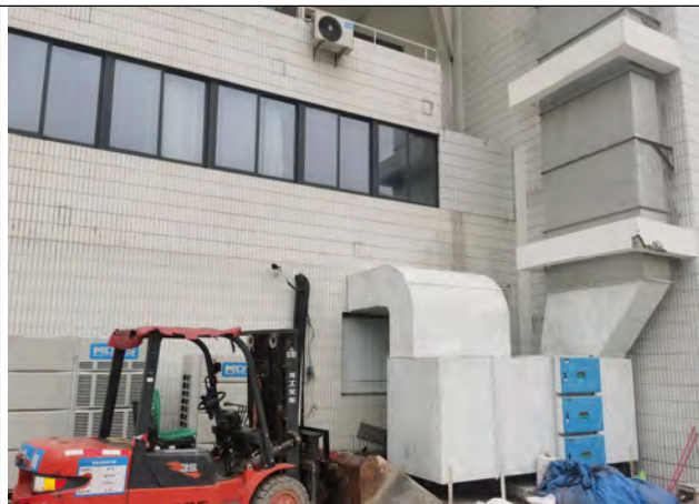
食堂油烟处理装置、排气管
