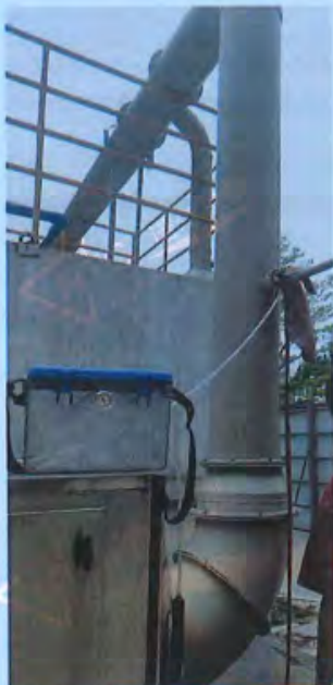
A1 污水站臭气处理前采样口
