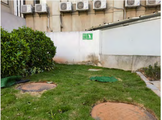
水-01 废水排放口（远）
