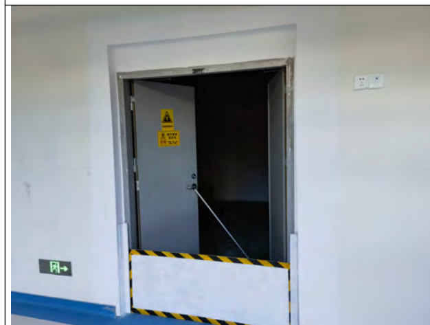
医疗废物暂存间防渗防外溢
