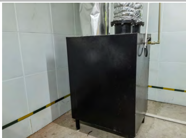
发电机尾气水喷淋装置
