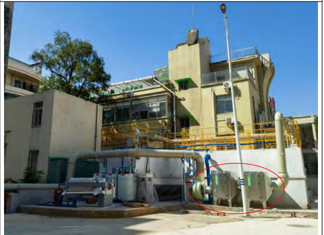
污水站臭气活性炭吸附装置、排气管
