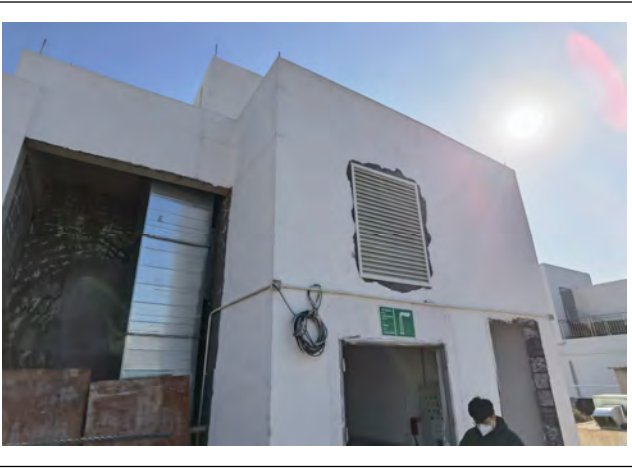
气-02 发电机尾气排放口（远）
