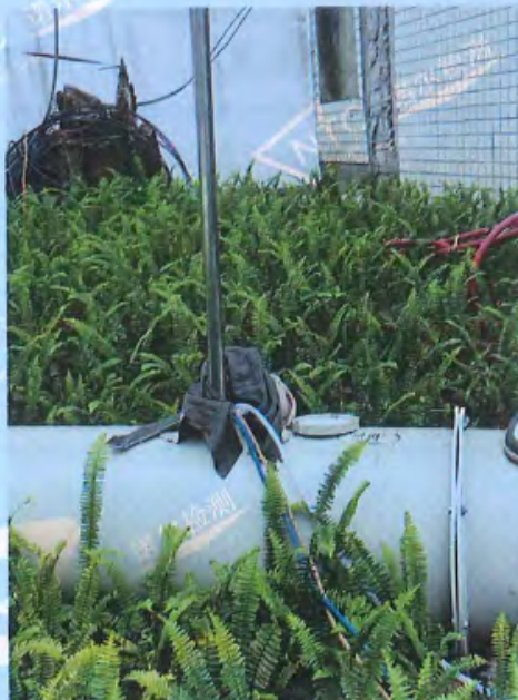
A2 污水站臭气处理后排放口
