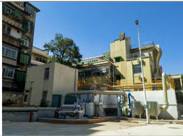
自建污水处理站
