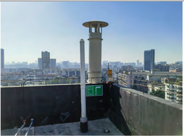
气-01 污水站臭气排放口（远）
