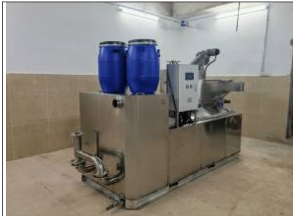
隔油隔渣设施（隔油提升一体化设备）
