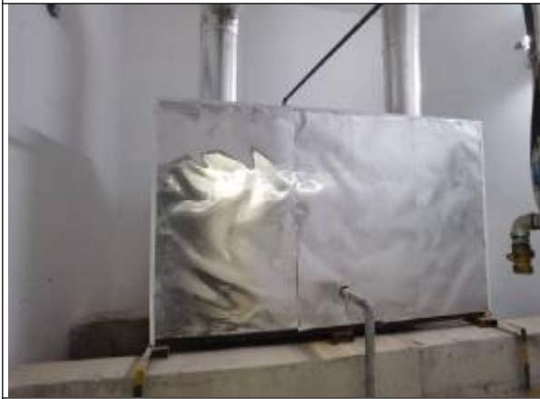
1#发电机尾气水喷淋装置
