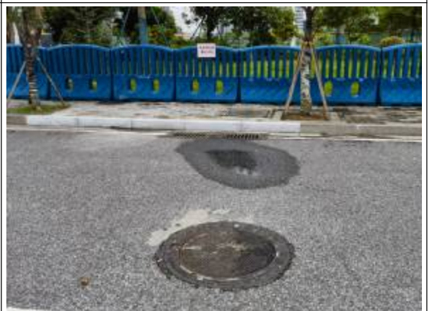
项目废水排放接驳入市政污水管网
