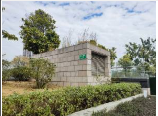
气-11 2#发电机尾气排放口（远）
