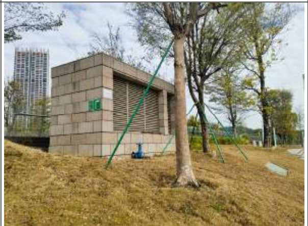
气-10 1#发电机尾气排放口（远）
