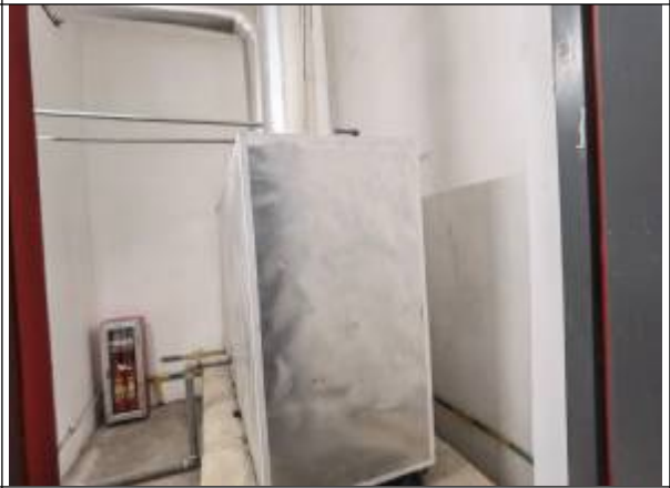
2#发电机尾气水喷淋装置
